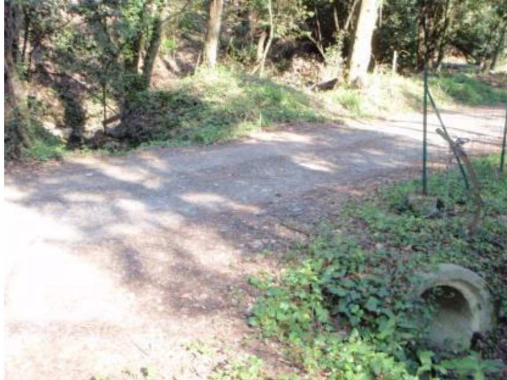
Figure 43 : Buse de franchissement de l'affluent au vallon des Vars (ARTELIA)
