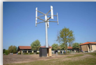
Éolienne Darrieus de 6 kW
